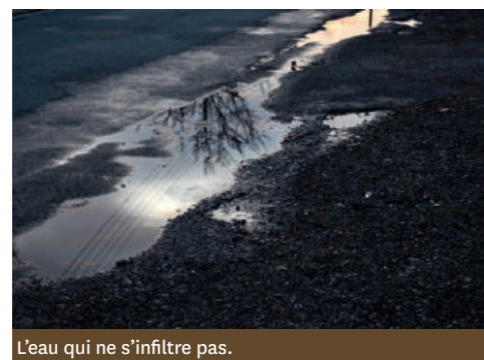
L'eau qui ne s'infiltré pas.
